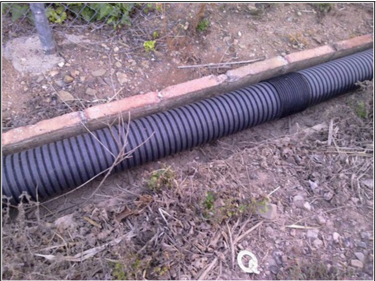
Rec d'obra reconvertit en canonada de plàstic
